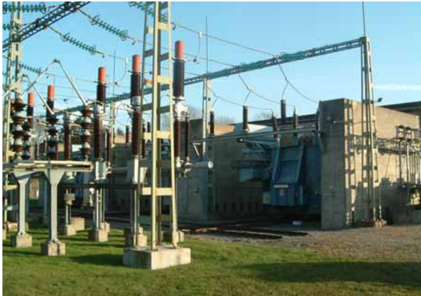
Mottagningsstation M1 med utomhusställverk.
